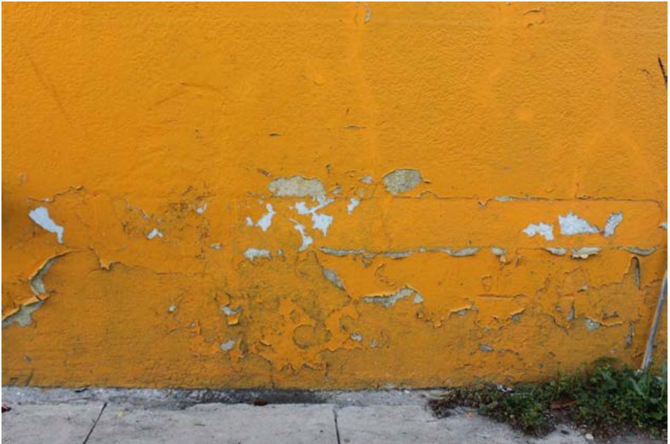
Paredes de la casa en Puebla/ House walls in Puebla
